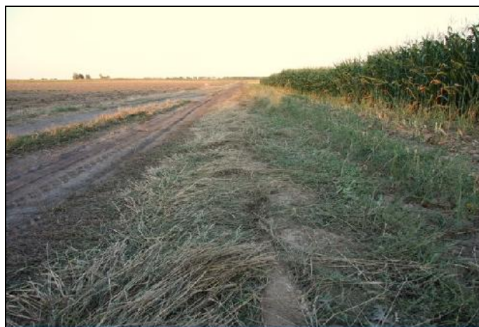
Rycina 16 Wygląd terenu po zakończeniu prac układania kabli metodą plużenia (źródło: http://thomsen.pl )
